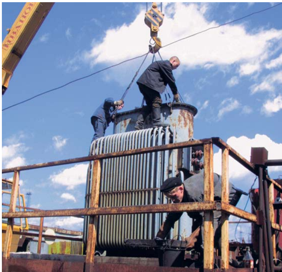
Venäläistä muuntajaa lastataan jatkokäsittelyä varten.
